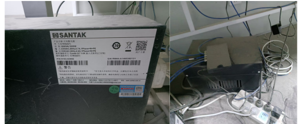
不间断电源系统
