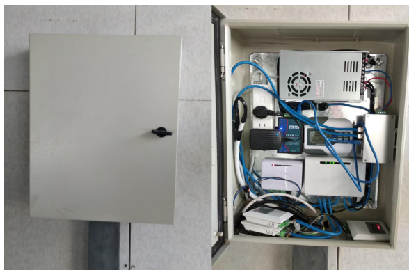
监测系统配电柜
