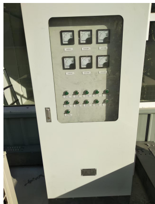
温控系统配电柜
